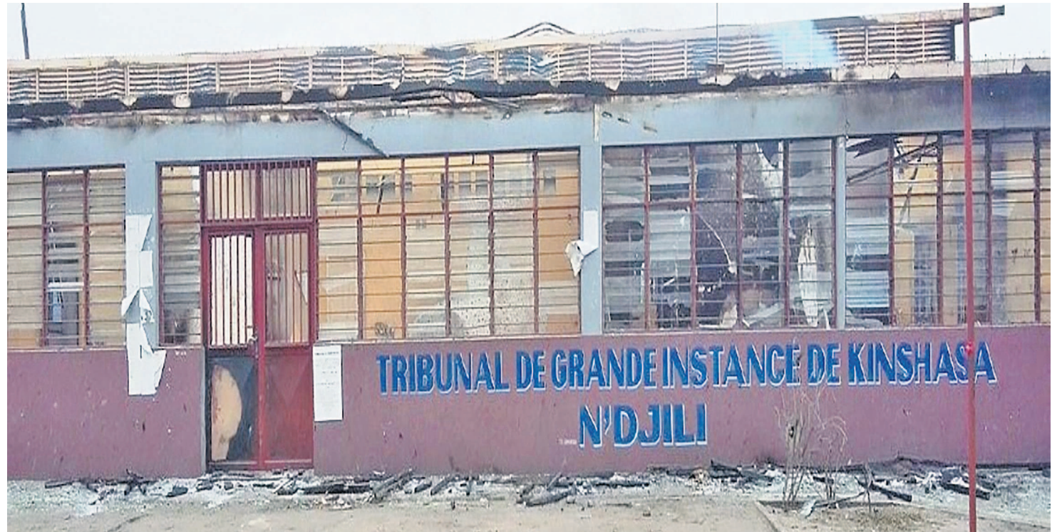
Le bâtiment incendié en novembre 2016 du TGI de Kinshasa/Ndjili
