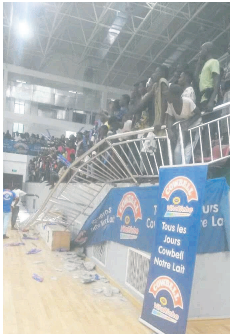
La barre de protection effondrée (Adiac)
