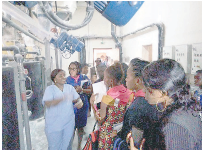
L'ingénieure Sifa expliquant aux étudiantes le processus de mélange nécessaire au traitement de l'eau (Adiac)
