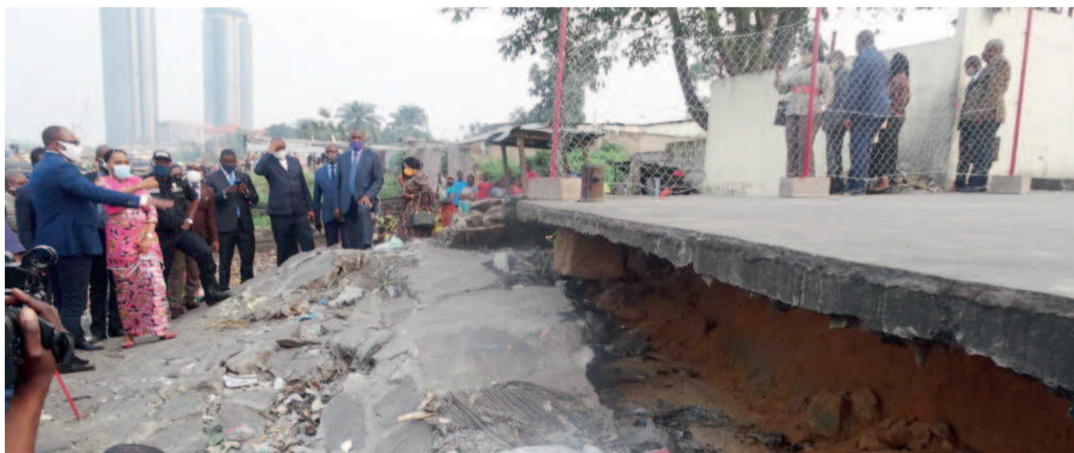
La ministre Ingrid Ebouka-Babackas visitant le quai dégradé par l'érosion
