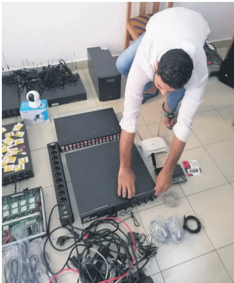
Le fraudeur devant les équipements installés sans autorisation
