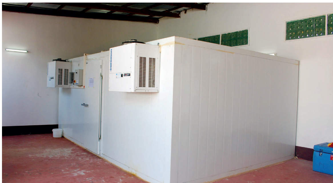
La chambre froide de stockage et l'approvisionnement des vaccins à Owando
