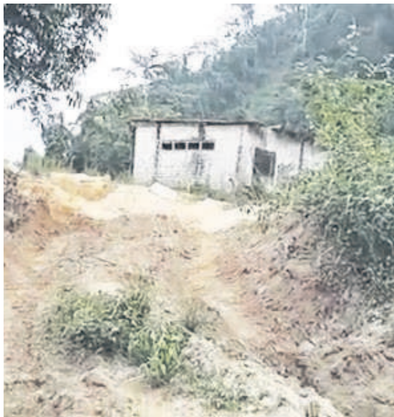
Une partie de stockage du matériel de construction du barrage dégradée
