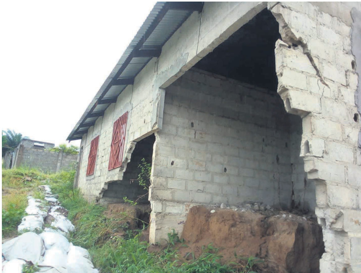
Une maison effondrée en 2020 non réparée par le PEPS Adiac
