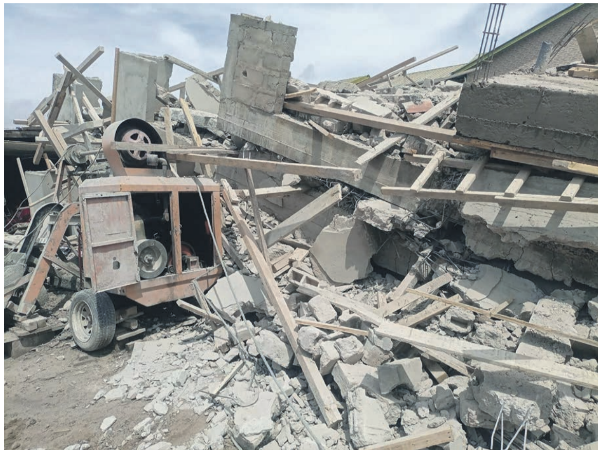
Effondrement d'un immeuble à Bacongo/Adiac
