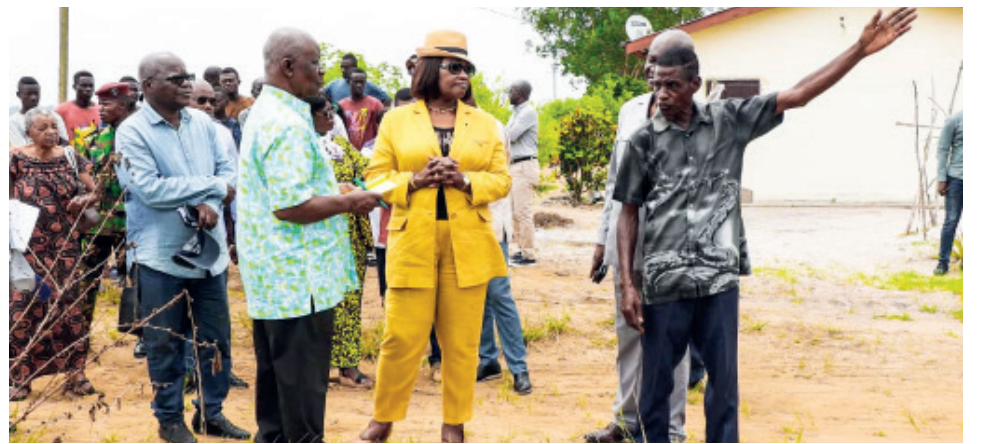
Visite du site de construction du laboratoire vétérinaire et une cité scientifique.
