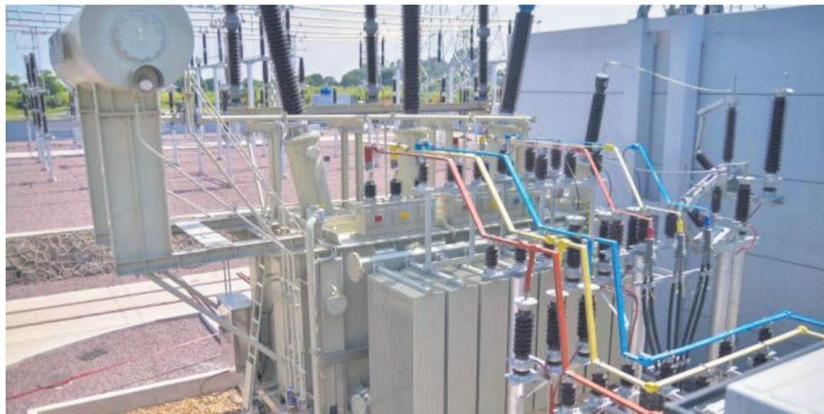
Un transformateur de la Snel à Kinshasa DR
