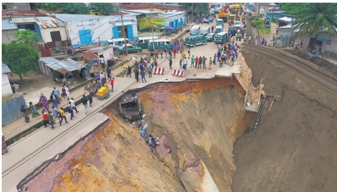
La route de Ngamakosso rongée par l'érosion, le 20 mars 2019/Adiac
