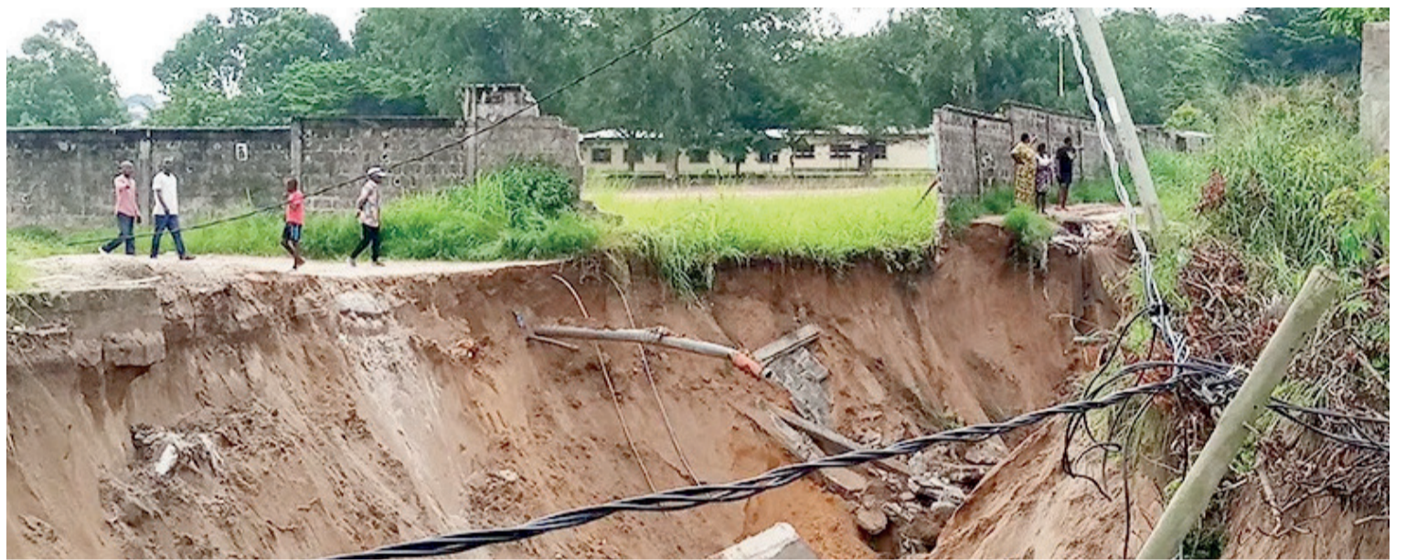
Une partie de la clôture du centre Don Bosco engloutie par l'érosion
