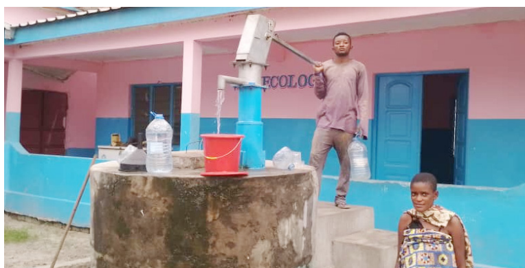
Un puits d'eau réfectionné par l'Unicef dans l'enceinte de l'hôpital de base de Mossaka/Adiac de la construction de la digue, l'accès à l'électricité ainsi que de de la protection des écoles, de l'érection des centres de santé et de la fourniture en eau potable, de intégrés.
